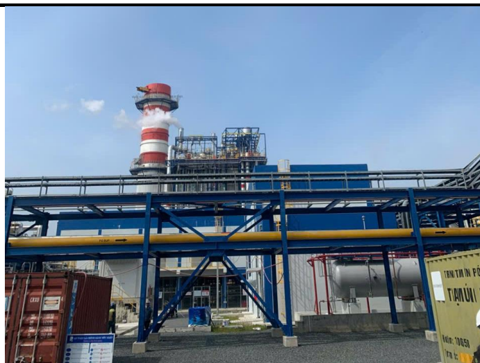
Hình 2: Nhà máy điện khí LNG NT3&4
