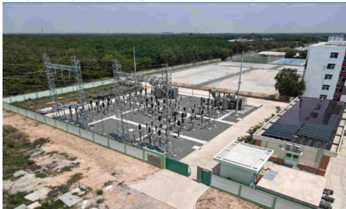
Bảng 34: Trạm biến áp tại KCN Phước Đông
